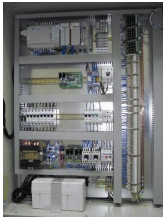
Figura 4.8 - Il quadro elettrico
